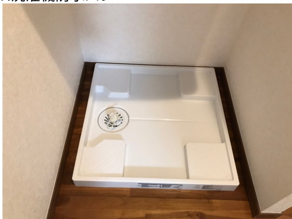
7.洗濯機防水パン
